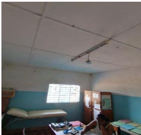
Maternité : appareillage électrique défaillante
