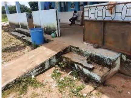
Marches d'escaliers en mauvais état
