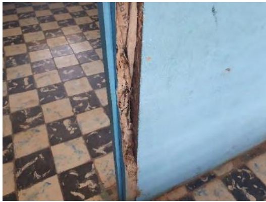
Dispensaire : cadre dégradé
