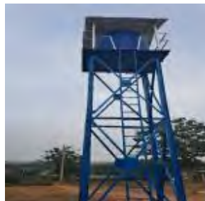
Photo 2 : Illustration de la source d'approvisionnement en eau potable de Botindé
