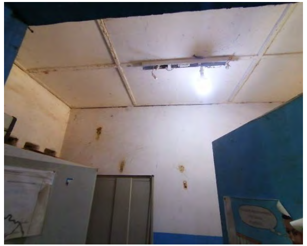
Dispensaire : appareillage électrique défaillante
