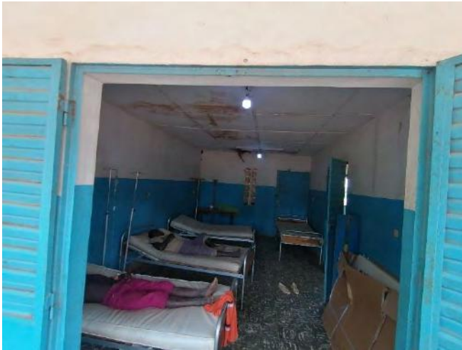
Dispensaire : problème d'étanchéité dans la salle de mise en observation
