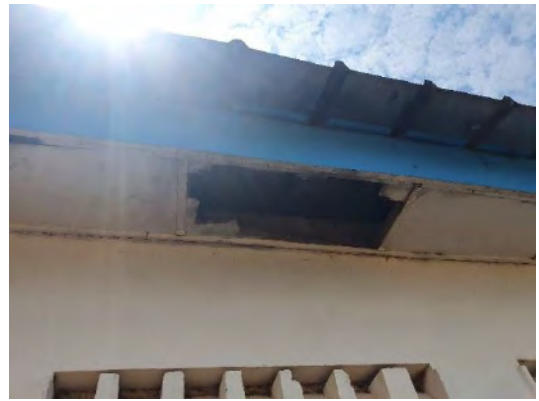
Maternité : état du faux plafond extérieur
