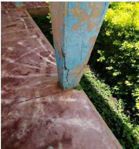
Maternité : fissure des poteaux de la passerelle
