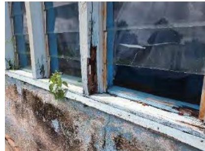
Etat de dégradation d'une fenêtre extérieure
