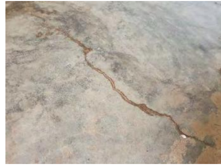
Fissure dans la chape
