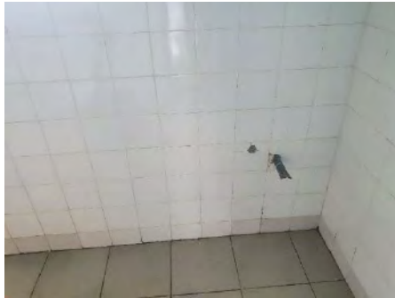
Absence d'appareil sanitaire
