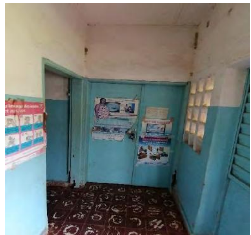
Maternité : vue sur l'état dégradé des portes
